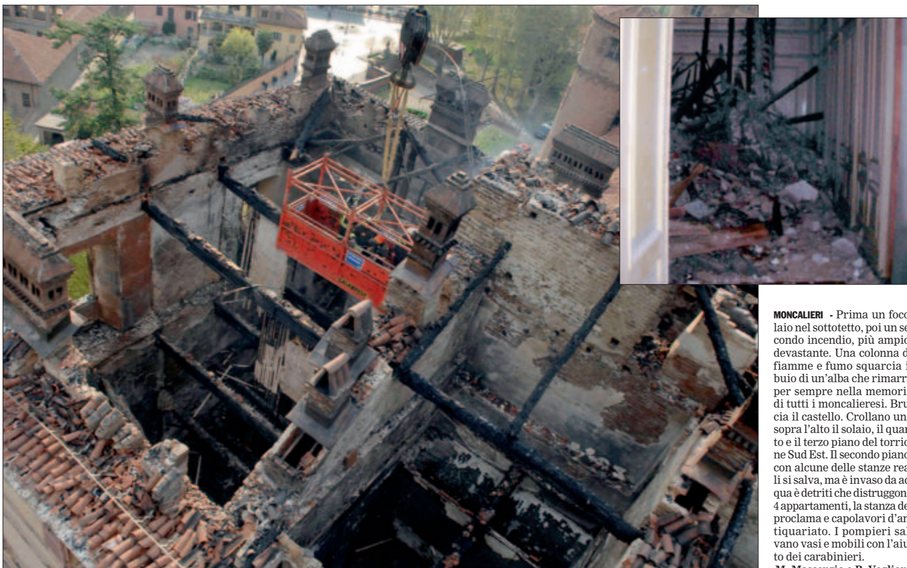
Il torrione sud est del castello sventrato dal fuoco che ha distrutto il tetto e fatto crollare i solai (in alto a destra)
