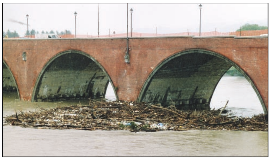
Le arcate del ponte vecchio ostruite dai detriti
