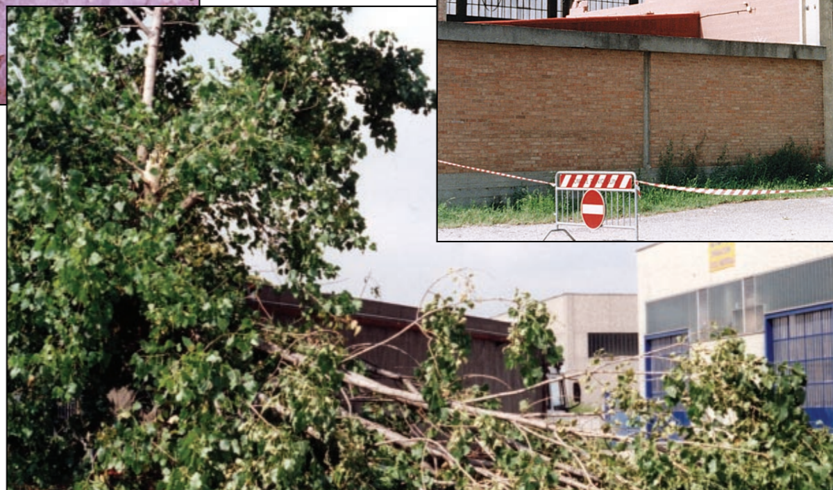
Alberi abbattuti nella zona industriale di Sotti Vernea. In alto, a destra, il muro esterno della Dectal di Nichelino, in via Voltumo 6, dopo il passaggio della tromba d'aria. A sinistra la grandine caduta a Moncalieri
